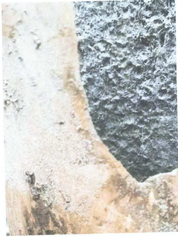
雨水接出管破损整改前
