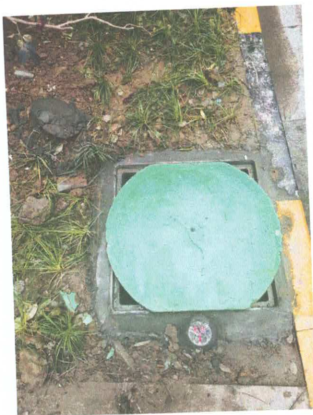
井盖未覆盖整改前
