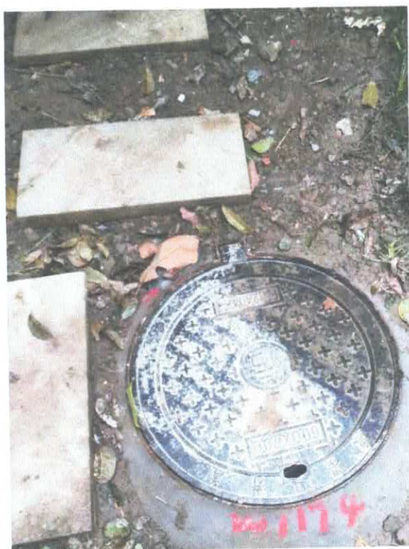
缺失标志标牌整改前
