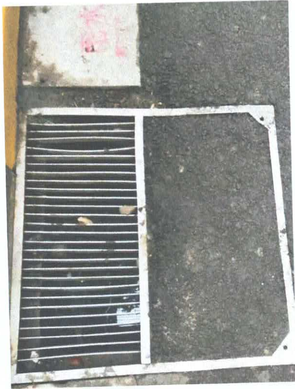
沥青破损修复前
